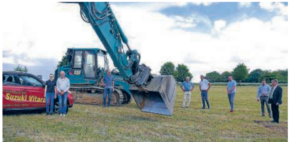
Mit dem symbolischen ersten Baggerbiss hat der Neubau des Autohauses Müller im Gewerbegebiet auf der Asbacher Höhe begonnen. Bild: H. J. Herpich-Weber
